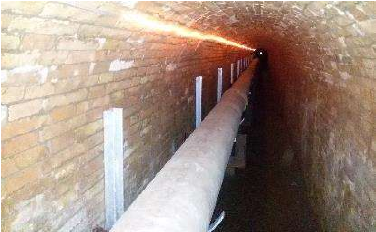
area dell'intervento in galleria: tubi acquedotto in cemento amianto con perdite attive sui manicotti a causa di movimenti sismici
