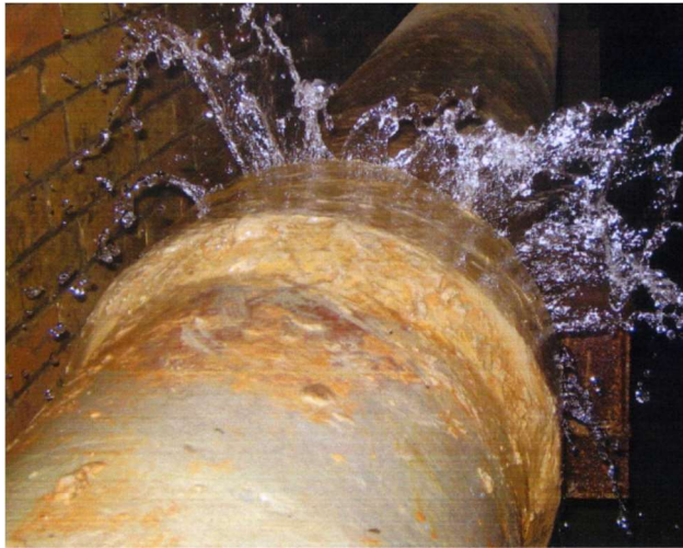
perdita attiva sui manicotti di giunzione
