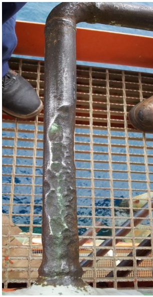
tubo acciaio 1' con evidenti segni di corrosione
